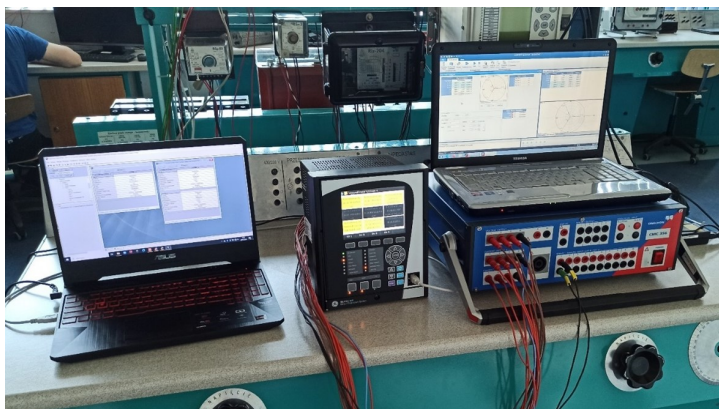
Rysunek 17.3. Zdjęcie stanowiska pomiarowego do badania kryteriów zabezpieczeniowych zabezpieczenia Multilin 869: 1 – laptop z oprogramowaniem EnerVista służący do programowania zabezpieczenia, 2 – zabezpieczenie Multilin 869, 3 – uniwersalny tester przekaźników OMICRON CMC 356 wraz z laptopem z zainstalowanym oprogramowaniem Test Universe, które służy to sterowania pracą testera
